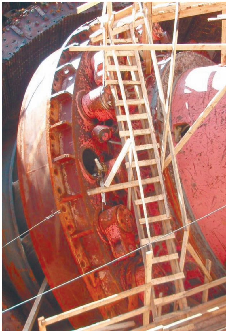
Рис. 3. Крышка ГА2 после откачки воды. Слева по окружности крышки идет фланец с помощью которого крышка крепилась с спиральной камере. Правее – цапфы лопаток направляющего аппарата с серьгами и сервоприводами. Одна из цапф вылетела при аварии (отертие на переднем плане).
