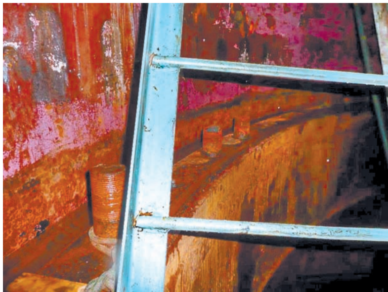
Рис. 1. Край колодца гидроагрегата (конструктивно является частью спиральной камеры, см. рис.3), к которому была прикручена крышка турбины, с остатками шпилек. Шпилька слева от лестницы – целая. Судя по ржавчине на резьбе, на ней уже долгое время не было гайки. На заднем плане – порванные шпильки.
